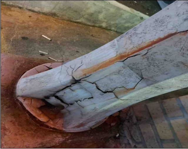
노후 가로등(FRP) 현장사진
